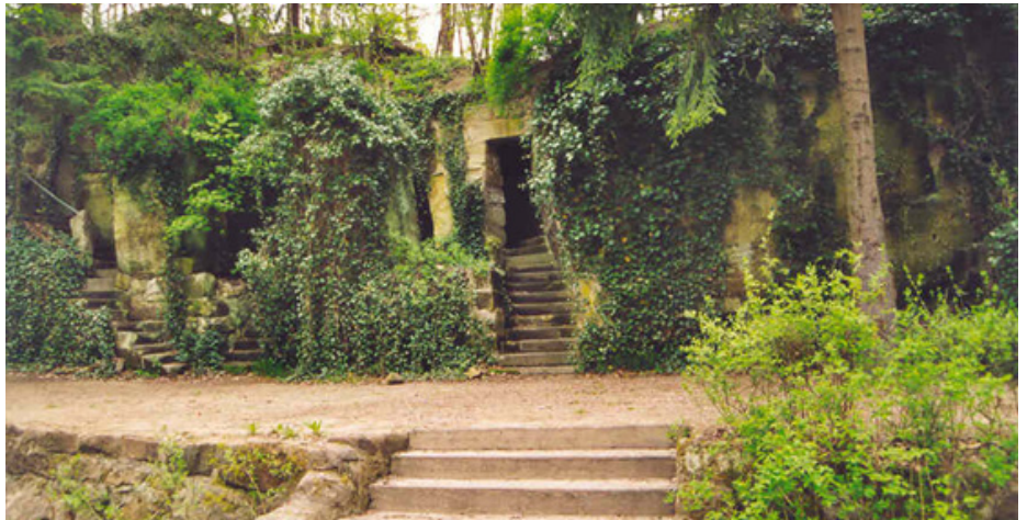
Die Naturbühne vor der Sanierung: Die Sicherheit für die Schauspieler konnte nicht mehr gewährleistet werden. Die Sandsteinblöcke mussten gesichert und Geländer erneuert werden.
